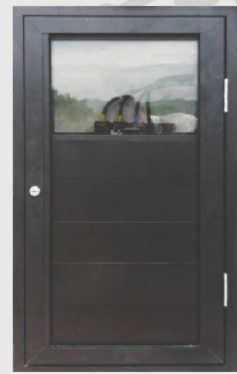
TNB METER DOOR
